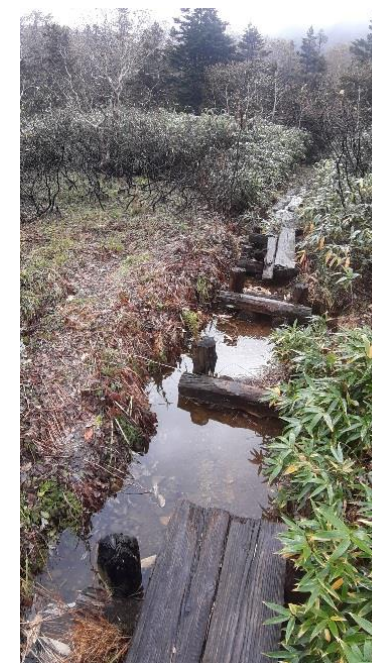
(お花畑・破損した木道)
