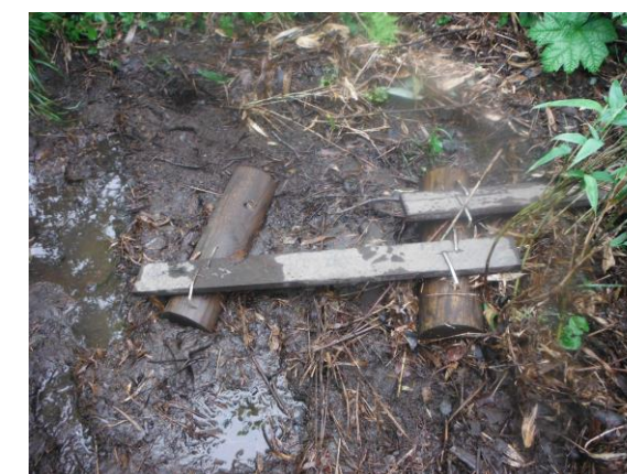
(破損した木道)
